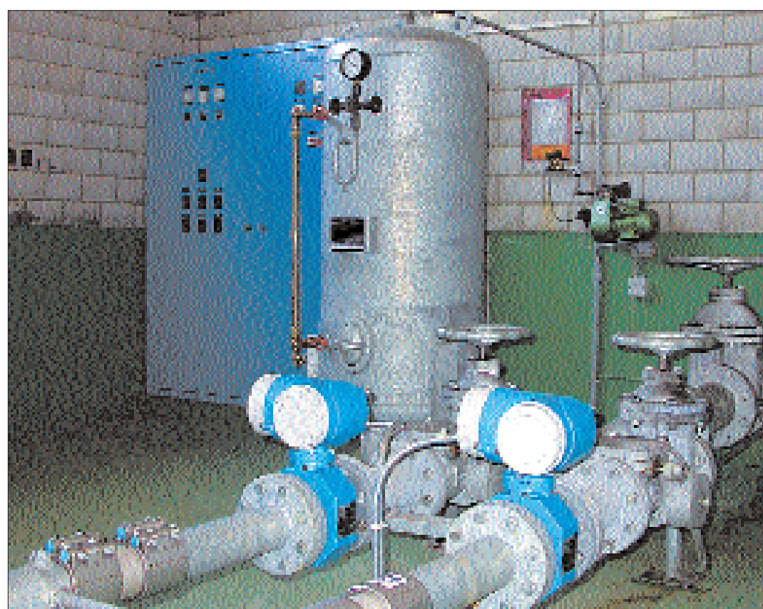
Zwei Grundwasserpumpen im Pumphäuschen «Lochbachweid». Die beiden Pumpen sind abwechslungsweise in Betrieb, so dass beide gleichmässig beansprucht werden.
