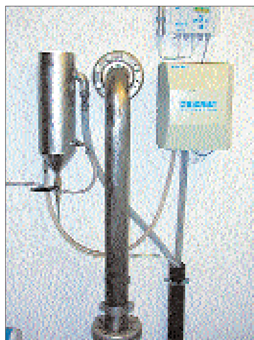
Ein Detail der Wasserversorgung: Dieses Messgerät misst die Trübungspartikel im Wasser und sorgt dafür, dass etwa nach einem starken Gewitter, trübes Wasser verworfen wird.
