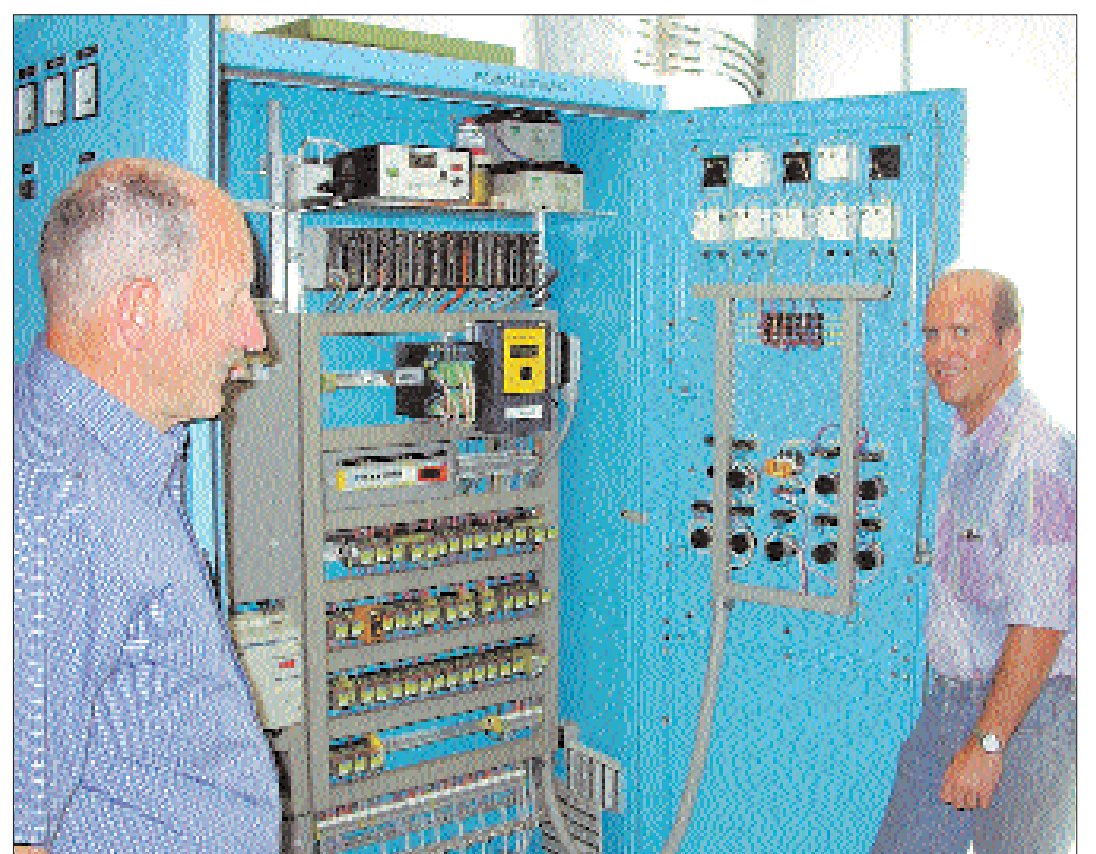
Der Steuerungsschrank im Reservoir Sonnebergli. Hier können die beiden Brunnenmeister Hansruedi Lütolf (links) und Werner Janssen jederzeit ablesen, wo wieviel Wasser einfliesst und wohin das Wasser geht.
